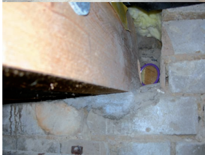
Bild 2: Balkenkopf bei einer Sanierung 2007 mit Bitumenbahn umwickelt im 4. Obergeschoß. Auch wenn diese Praxis bereits im 19. Jahrhundert nicht den anerkannten Regeln der Technik entsprach, wird sie auch im 21. Jahrhundert immer noch angewandt!
